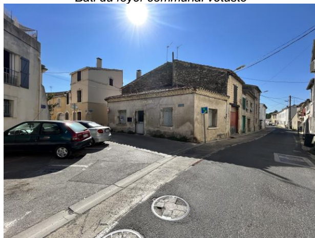
Bâti du foyer communal vétuste
